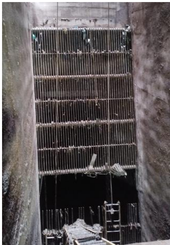
Fig. N° 06 – Vista desde el atrio del estado de la reja actual en la nave D – Obra de Toma, marzo 2025
