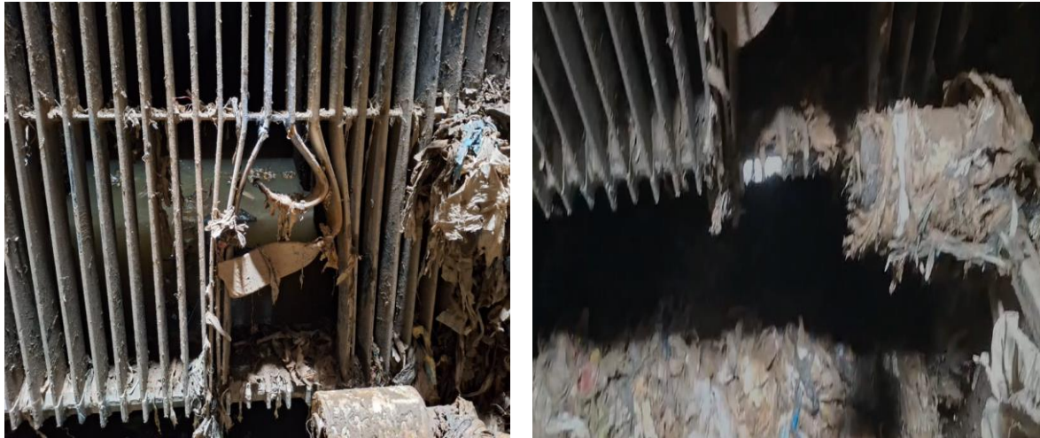
Fig. N° 05 – Estado de la reja actual de la reja instalada en la nave D – Obra de Toma, marzo 2025, el estado es similar en las naves B y C.
